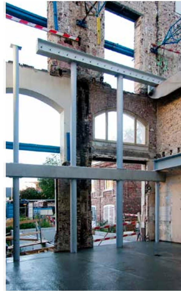
Opstand achtergevel (nieuwe structuur voor oude structuur)_Relevé de façade arrière (nouvelle structure remplaçant une ancienne structure)
